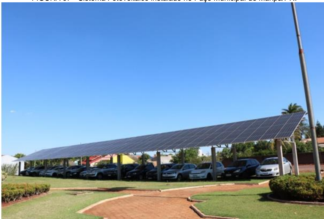
FIGURA 07 - Sistema Fotovoltaico instalado no Paço Municipal de Maripá/PR.
