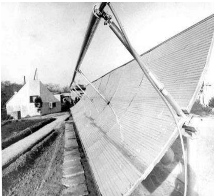
Рис. 1. СЭС с параболоцилиндрическими концентраторами в г. Ашхабаде, м. Бикрова, 1986 г.
