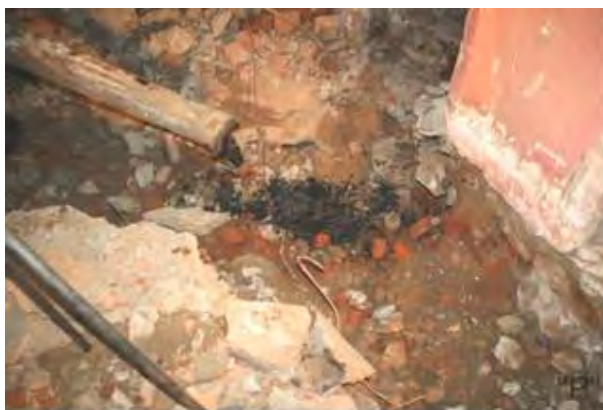
Рис. 3. Разрушенный трубопровод спецканализации.
