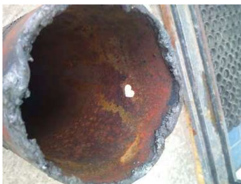
Рис. 3. Коррозия газопровода (г. Киров, ул. Некрасова)
