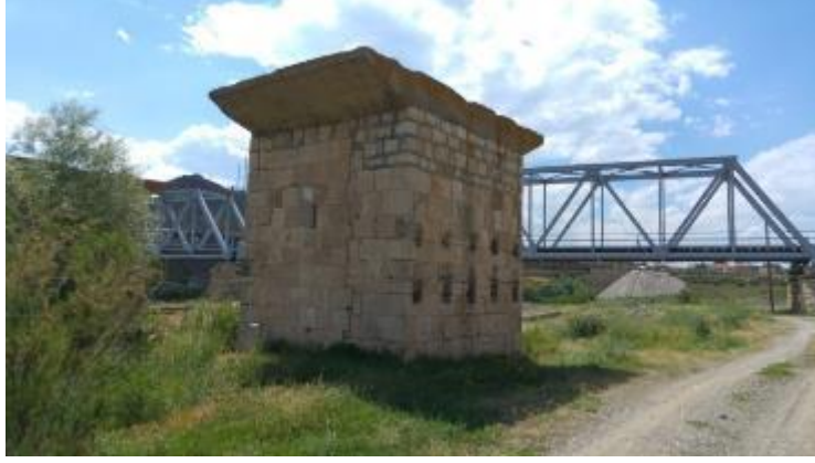
Şekil 11. Ayaklarda dikey yönlü oluşan hasarlar (Fotoğraf:M.Sağır)
