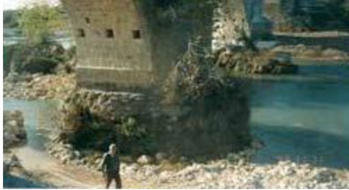
Şekil 1. Aspendos Köprüsünde ayaklarda oyulma [3,5]
