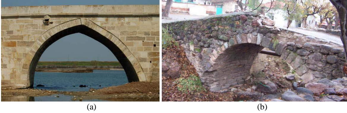
Şekil 6. (a) Onarım sonrası deforme olmuş Büyükçekmece Köprüsü [5], (b) cephe duvarlarında yıkımları olan Tarihi İğnedere Köprüsü[7]
