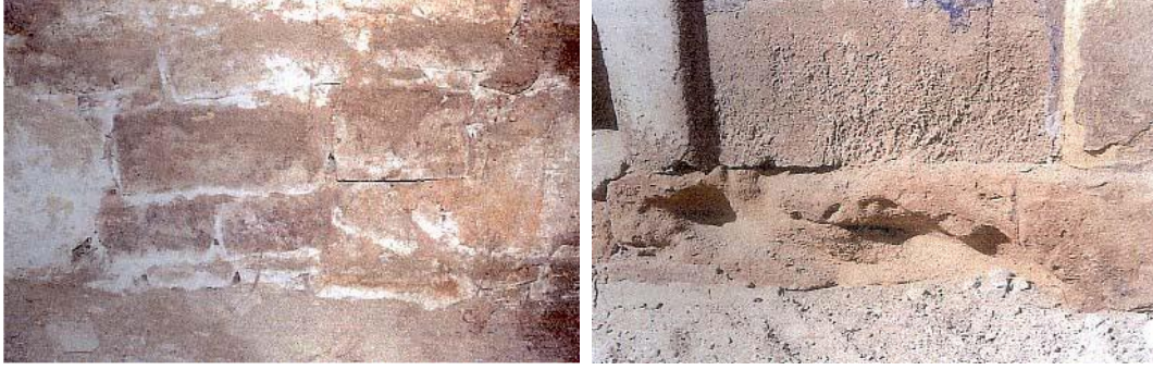
Şekil 5. (a) Taşlarda tuzlanma, (b) Donma çözülme etkisiyle oluşan hasar
