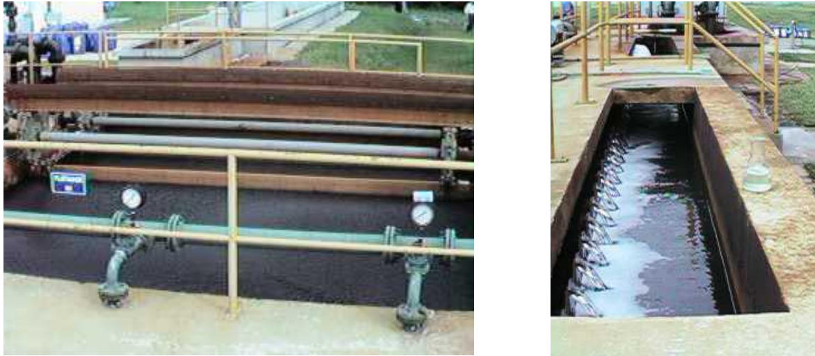
Figura 6.9 – Vista da unidade de flotação da ETE Cambuí (Campo Largo/PR)
