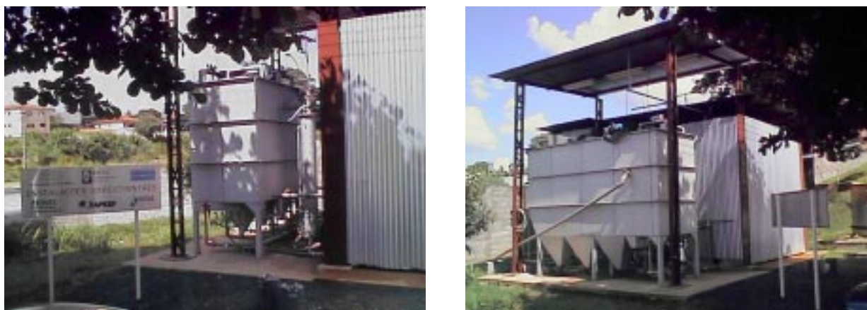
Figura 6.11- Sistema de flotação por ar dissolvido com capacidade de 10 m 3 /h, implantado no Campus-USP de São Carlos, pelo Departamento de Hidráulica e Saneamento, para o pós-tratamento do efluente de reator anaeróbio de leito expandido, tratando esgoto sanitário.
