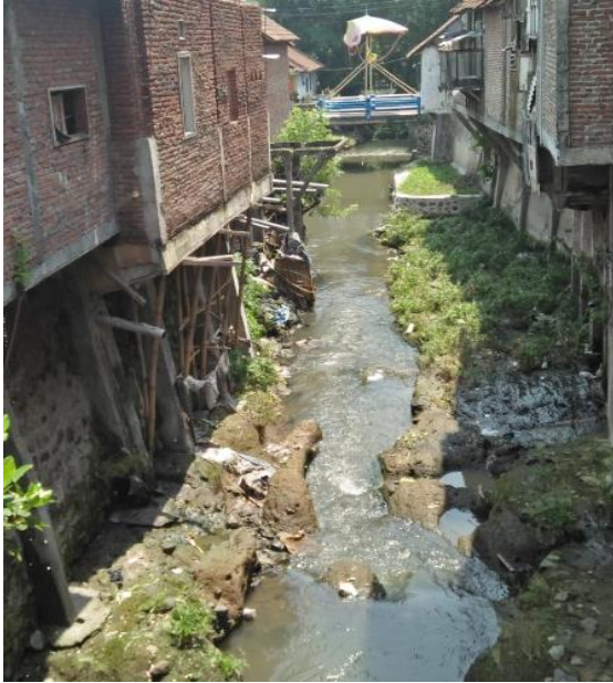
Gambar 2. Pondasi dan bangunan rumah tinggal yang menutup dan mempersempit badan sungai
