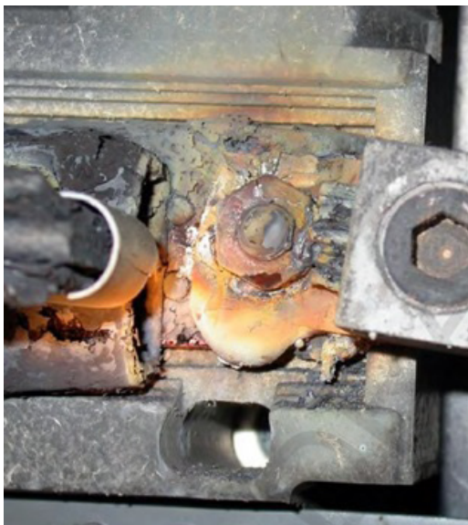
Obrázok 8-8 Zoxidovaný kov v mieste zvýšeného prechodového odporu (NFPA 921:2014)
