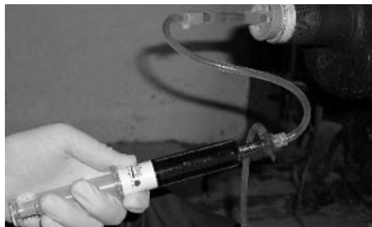
FIGURA 7.24 Toma de muestras de gases del relevador Buchholz
