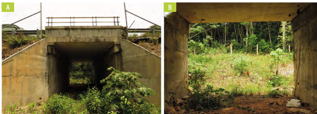
Figura 5. Imágenes de los PSF que operan en la carretera Nuevo Xcan-Playa del Carmen. A) PSF en el que se observa el mantenimiento llevado a cabo por la concesionaria de la carretera, que consiste en el retiro de vegetación arbustiva, rocas y troncos. (Fotografía: Alberto González-Gallina.) B) Interior de un PSF en el que se observa el retiro de vegetación arbustiva hasta el derecho de vía, llevado a cabo por la concesionaria de la carretera. (Fotografía: Alberto González-Gallina.)
