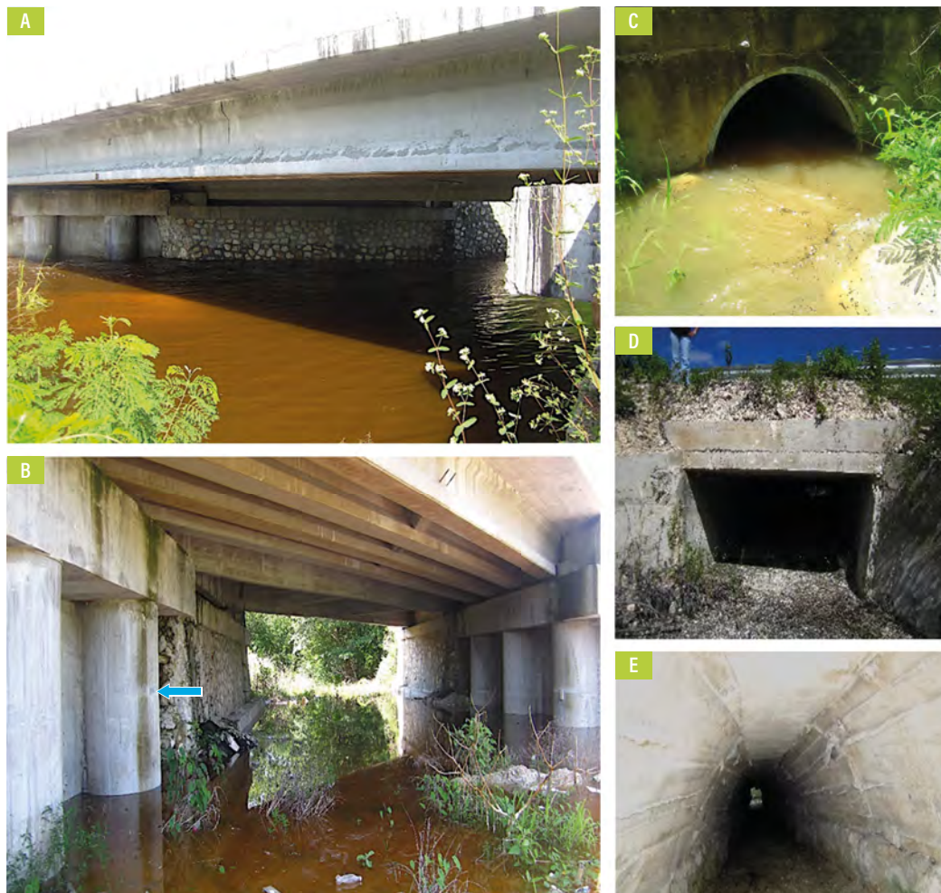
Figura 2. A) Puente Calakmul y escorrentías de aguas superficiales durante la época de lluvias. B) Puente Morelia, escurrimiento de aguas superficiales en época de lluvias; la flecha azul indica los límites máximos del nivel de agua alcanzado. C) Escurrimientos superficiales en época de lluvias a través de la obra de alcantarillado. D y E) Diferentes obras de drenaje presentes a lo largo del sitio de muestreo. (Fotografías: Marlen Sánchez-Acuña.)
