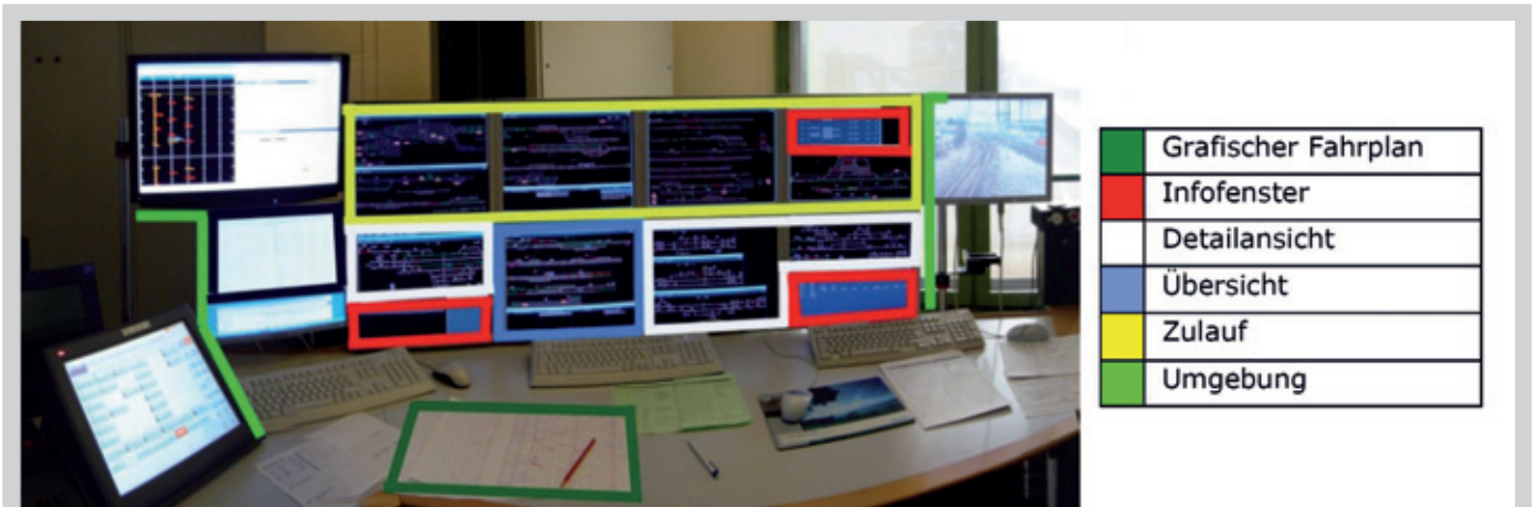
Bild 2: Arbeitsplatz eines Zugverkehrsleitenden, eingeteilt in verschiedene Bereiche
