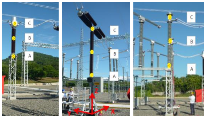
Figura 3 Instalación de acelerómetros en equipo eléctrico no energizado
