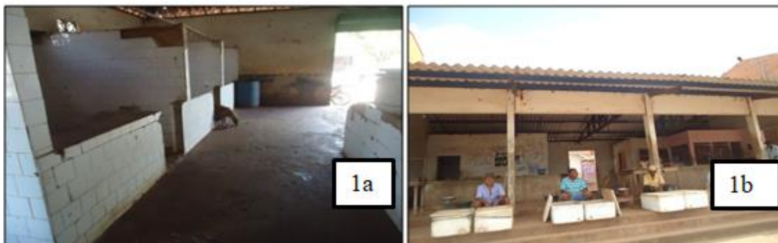
Figura 1 - Instalações físicas dos mercados A e B no município de Zé Doca – MA. 1a) Piso e parede em péssimo estado de conservação no mercado A; 1b) Piso e parede de difícil higienização no mercado B;
