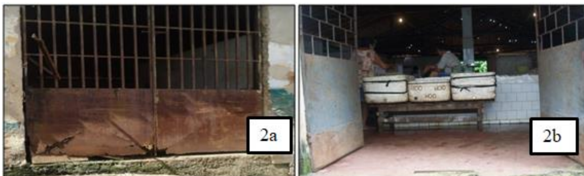
Figura 2 - Portas oxidadas e em péssimo estado de conservação mercado A (2a e 2b).
