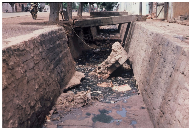
Fig. 1 Les caniveaux éventrés par manque d'entretien forment des collections d'eau polluées où pullulent Culex pipiens quinquefasciatus - Bobo-Dioulasso, Burkina-Faso (1985) / Gutters in a state of disrepair for lack of maintenance, thus generating polluted water collections where Culex pipiens quinquefasciatus proliferate - Bobo-Dioulasso, Burkina-Faso (1985) (© F. Darriet)
