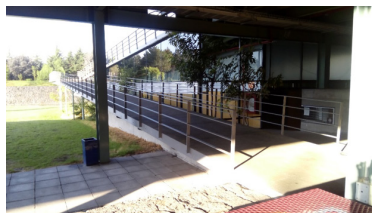
Imagen 4. Rampa existente desde el año 2000, cuando se construyó el edificio del CEDETEC, en el Tecnológico de Monterrey, misma que se aprecia que carece de los descansos necesarios (Solano 2018).
