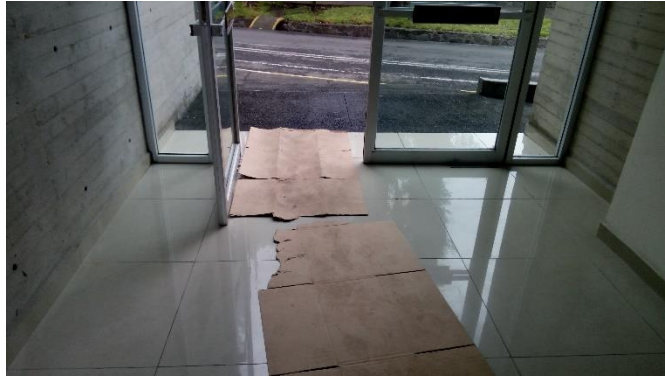
Figura 14. Entrada al edificio de Posgrado con acabados poco pertinentes a las condiciones climáticas de la ciudad., 2017.
