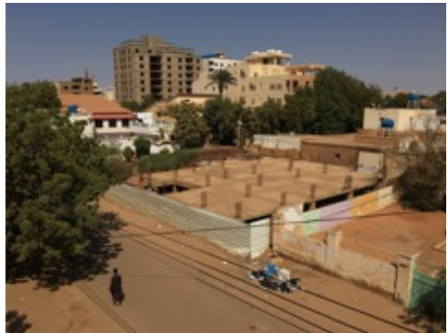
Figure 32 : Chantier abandonné à Khartoum 2. © CPH, février 2020
