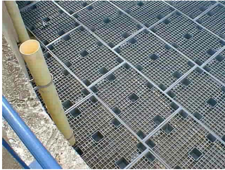
Figura 11.6. Vista superior, en detalle, del fondo de un filtro percolador con relleno plástico
