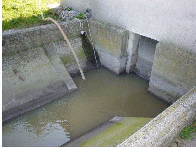
Figura 4.3. Vista de un desarenador
