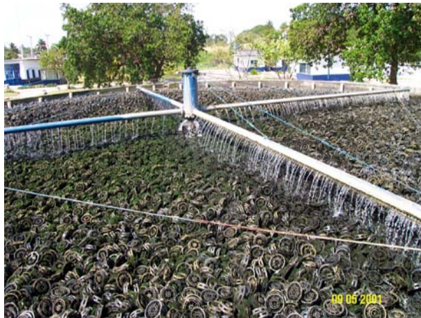
Figura 11.4. Filtro percolador de distribuidor giratorio
