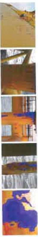
Abbildung 4: Verschiedene Abbaugrade (Ri) an Korrosionsschutzbeschichtungen als Ergebnis digitaler Bildverarbeitung (Bezugsflächendefinition erfolgte manuell); von links in %: 0,5; 1,3; 11,3; 17,4; 54,1 (Momber, 2016)
