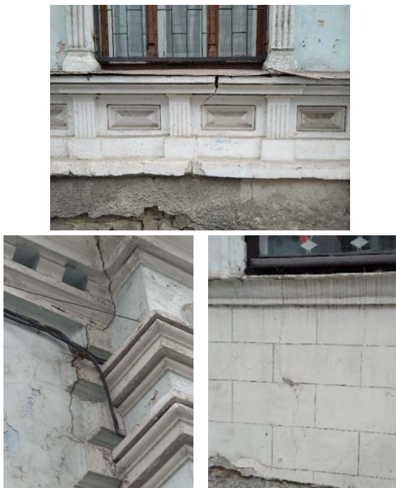
Fig.3.17. Fisurarea pereților clădirilor monumente arhitecturale
