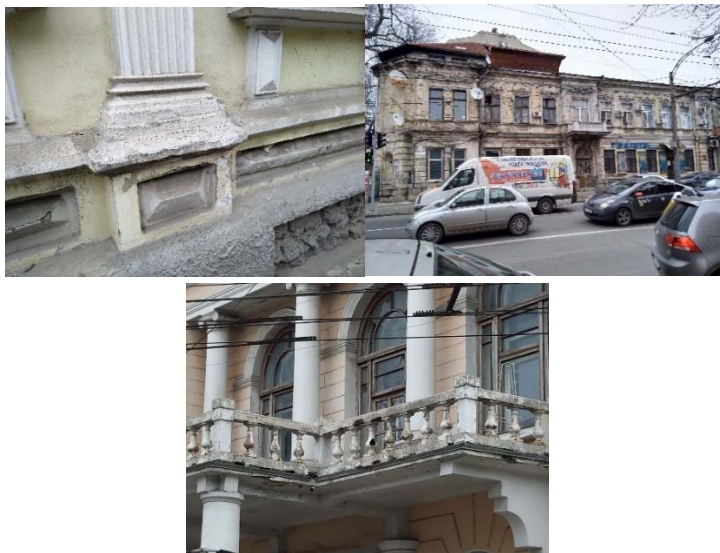
Fig.3.16. Starea fațadelor clădirilor monumente de arhitectură amplasate pe str. București, 10–15 ani după reparație
