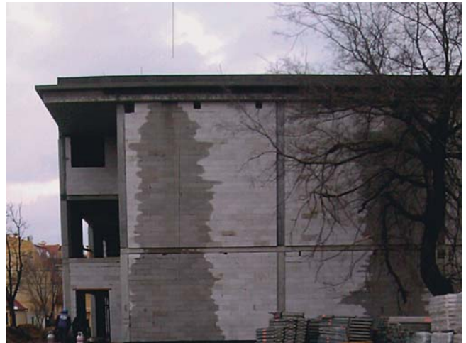
1. ábra. Oldalfali nedvesség
