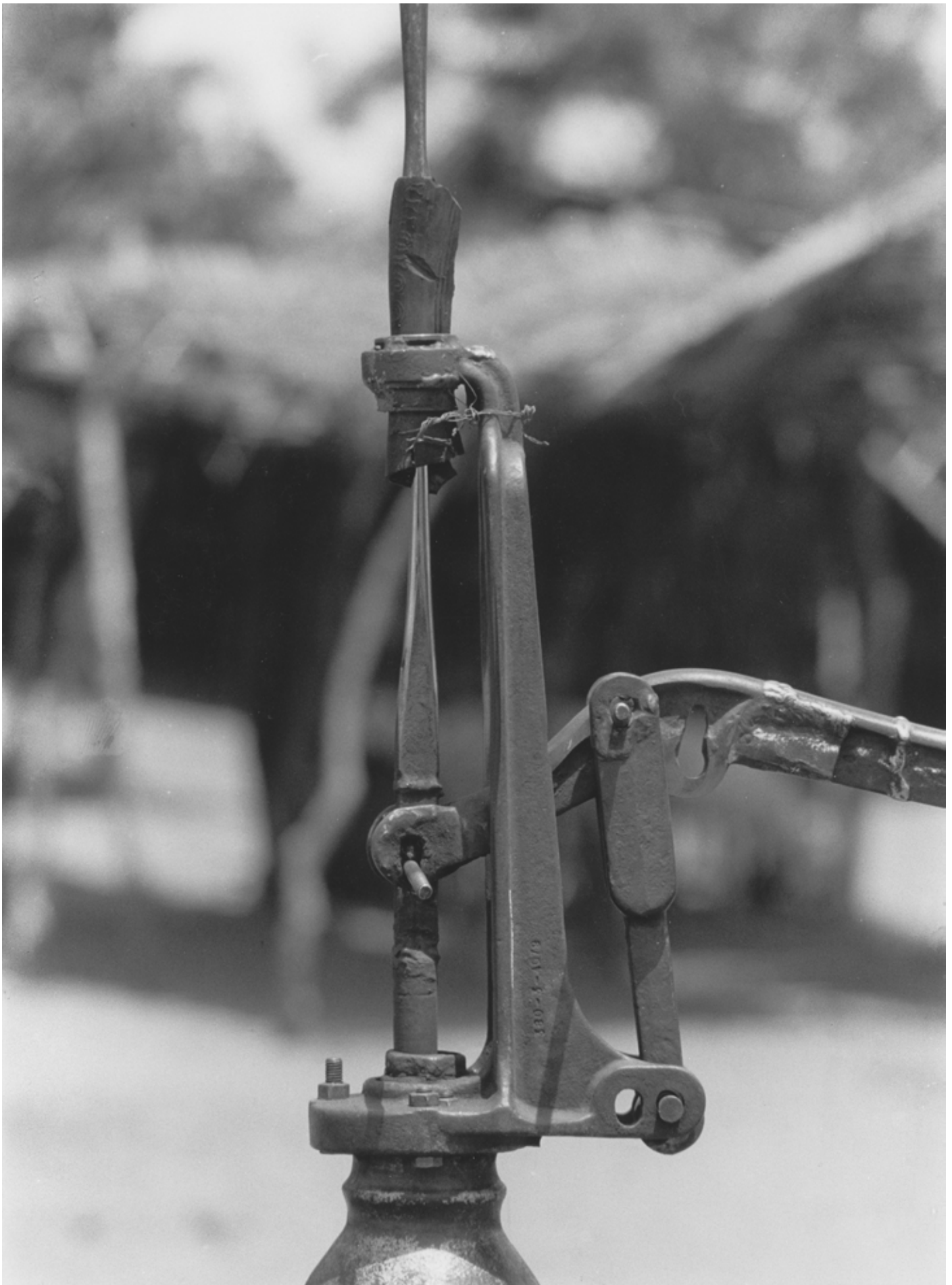
Pompe « Dempster » de fabrication américaine installée en 1959, entretenue par le forgeron du village. Si l'on compte bien, sur cette photo on peut identifier 18 réparations - Sénégal, 1976
